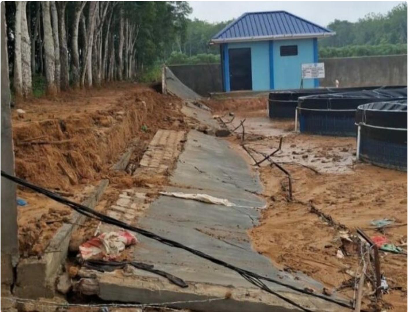
Pagar pembatas Balai Benih Ikan (BBI) Air Tawar di Mesuji -Bukoposo Roboh
